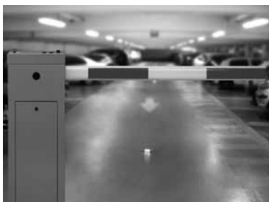
Шлагбаум, управляемый ПЧ ATV 12
